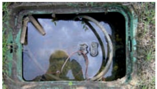
Bild 2: Hydranten- und Decoderbox im ordnungsgemäßen Zustand
